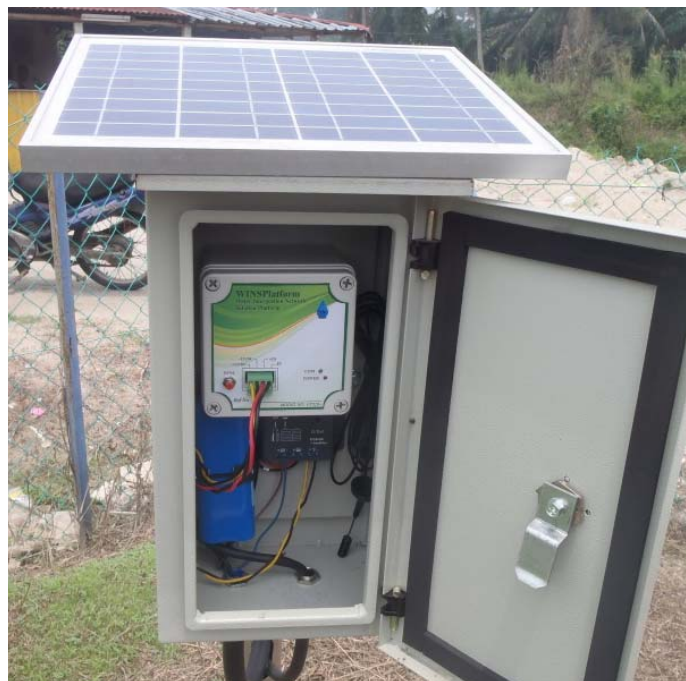
Gambarajah menunjukkan RTU sedia ada.
